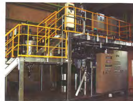
白色腐朽菌による色素分解処理実証プラント(RSP)
