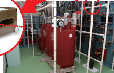
電気室の例。まる囲みが変流器。中央の赤いのが変圧器(利昌工業製)。
