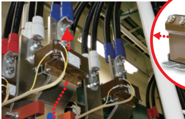
変流器を矢印方向に突き抜けるように大きな電流が流れる。細い黄色の線がリレーにつながっている。
