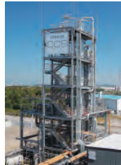
三川CO 2 分離回収パイロットプラント
