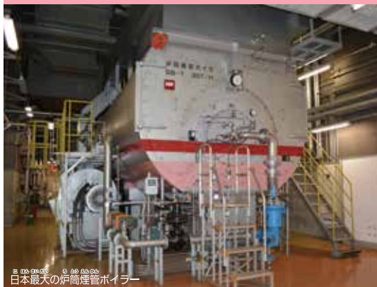
日本最大の炉筒煙管ボイラー
